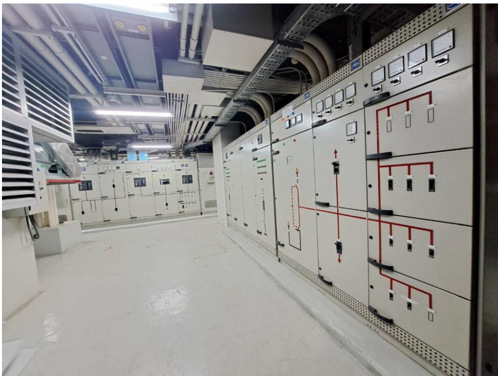
สถานที่ติดตั้ง MDB ของเดิม ชั้น B1 อาคารราชนครินทร์
