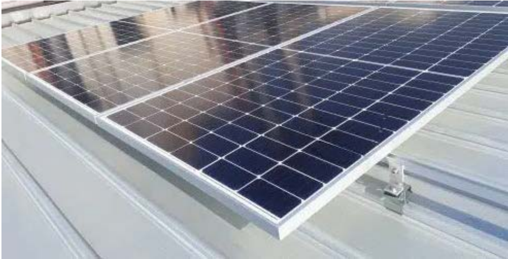
ตัวอย่าง การติดตั้งอุปกรณ์พลังงานแสงอาทิตย์บนหลังคาเมทัลชีท
