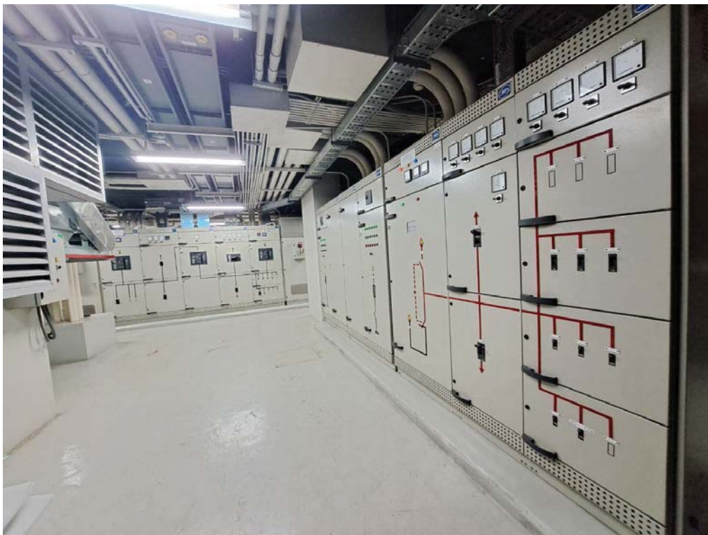
สถานที่ติดตั้งตู้ MDB ของเดิม ชั้น B1 อาคารราชนครินทร์
