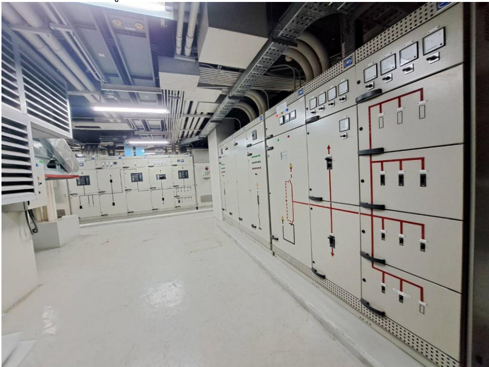
สถานที่ติดตั้ง MDB ของเดิม ชั้น B1 อาคารราชนครินทร์
